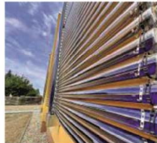
Solarpaneele an der Giebelwand zur Warmwassergewinnung.
